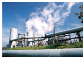
澄川地熱発電所(秋田県鹿角市)
